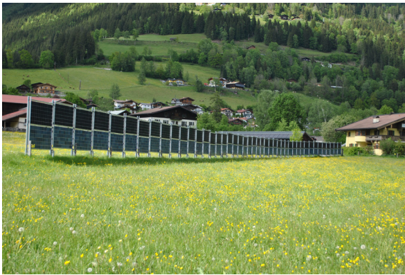
Abb. 19: An der Grenze zwischen einem Fahrweg und einer Wiese (Rinderweidefläche) wurden vertikal montierte PV-Paneele aufgestellt, welche beidseitig die Sonnenenergie nützen können, einmal Richtung Osten und einmal Richtung Westen. Gleichzeitig fungiert diese PV-Wand als Schutzzaun. Die Wiesenfläche kann ungehindert gemäht werden, die Stellen um die Stützen müssen händisch nachgemäht werden. Im Landschaftsbild stellt diese PV-Wand einen optischen Eingriff dar. Er wird jedoch dadurch gemildert, dass die Oberkante unterhalb der Gebäudesilhouetten liegt.
