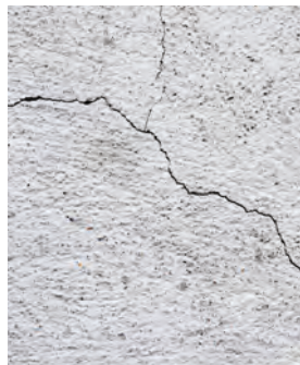
der Riss la fissure pęknięcie n растрескивание n
