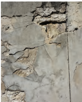
der Betonschaden la dégradation de l'enduit korozja betonu f коррозия бетона f
