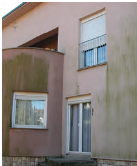
die Verschmutzung l'encrassement zabrudzenie n загрязнение n
