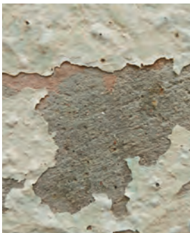
die Abplatzung l'effritement odpadanie n отпадание n
