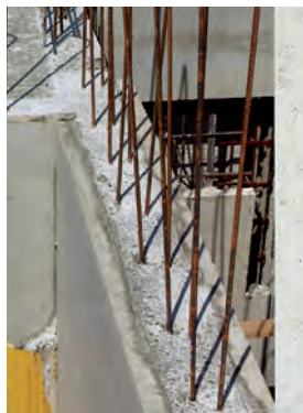
der bewehrte Beton umg der Stahlbeton le béton armé beton zbrojony m железобетон m
