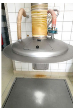
die Staub- absaugung am Mehlsilo dust extracting system
