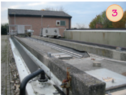
3 Sandfang: Hier sinkt der Sand nach unten und wird durch eine Pumpe abgesaugt.
