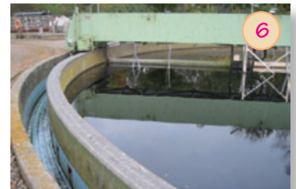
6 Nachklärbecken: Bakterien sinken nach unten. Der Bakterien Schlamm wird abgepumpt und in den Faulurturm geleitet, sauberes Wasser fließt in den Fluss.
