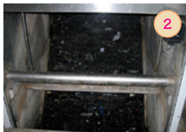
2 Der Rechen: Er filtert groben Schmutz aus dem Abwasser.
